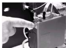
Rys. 21. Lampka sygnalizacyjna na sterowniku palnika
